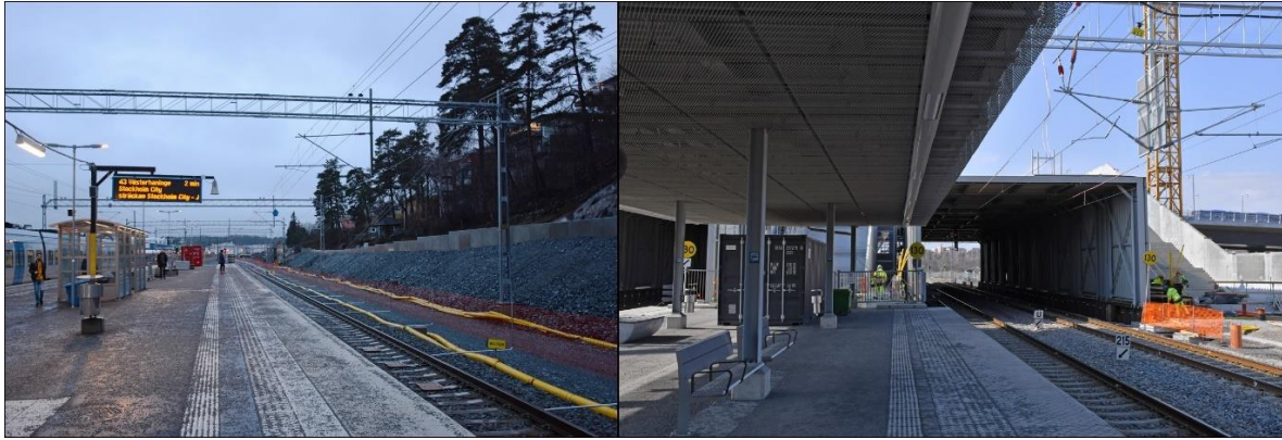
T.v. Spånga station 2018 när fyrspåret höll på att byggas. Foto Tobias Jäderup.
